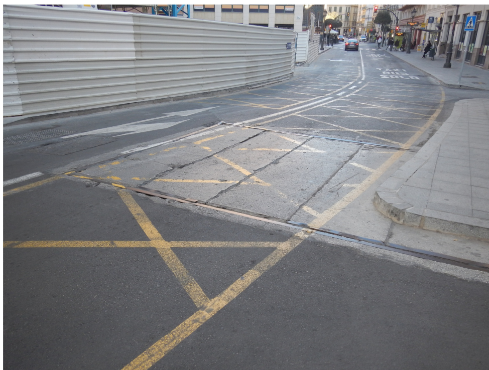
Atarazanas, riesgo de tropiezos de la propia comitiva por firme irregular
